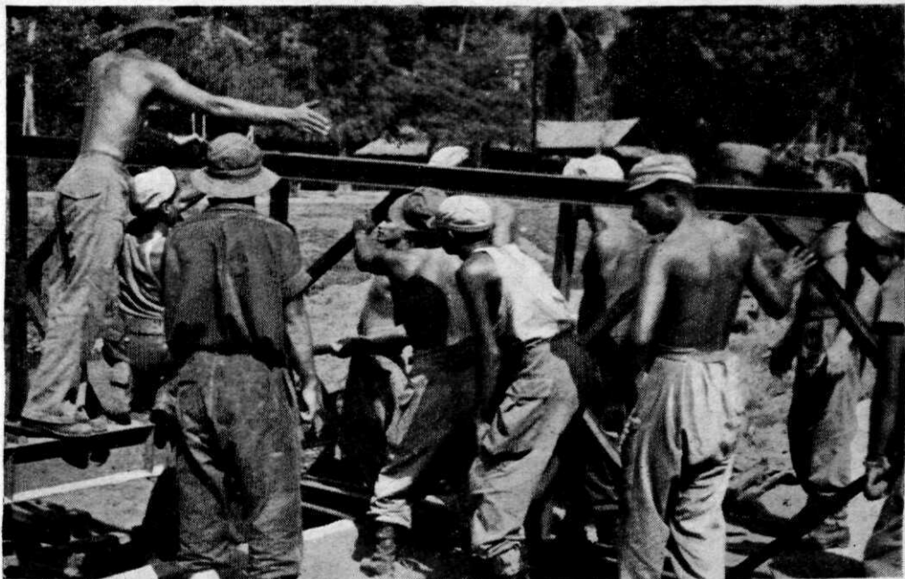
De 1e Veldcompagnie Genietroepen bezig met het bouwen van een 1—1 Baileybrug in de Djakarta-weg te Batavia. — De ploegcommandant geeft aanwijzingen bij het aanbrengen van een raam.
